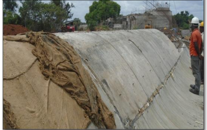
Clear Over Spill
