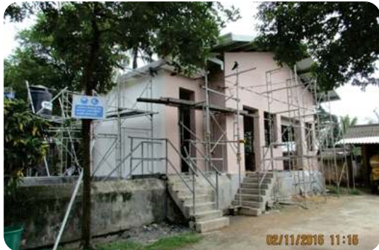
KP 3 Site SCADA Room
